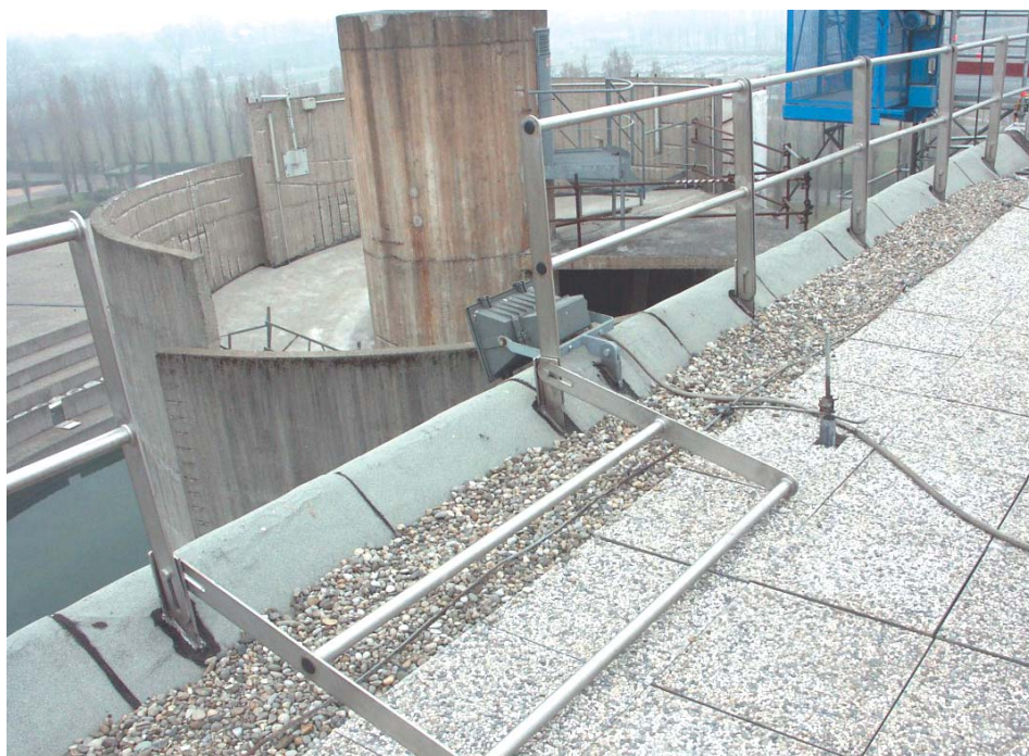
Vista del parapetto perimetrale antinfortunistico con un settore ripiegato.
